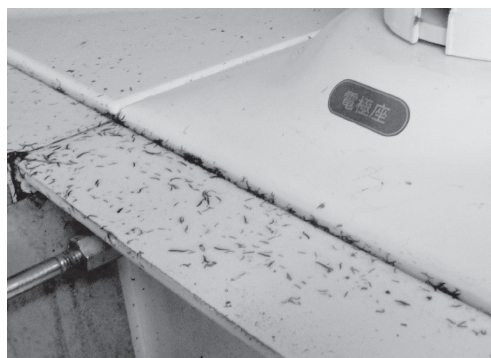
写真1 汚水管からの漏水に発生した ショウジョウバエ幼虫
